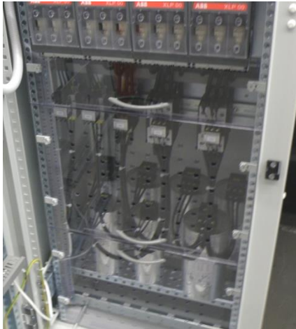
Příklad krytí kompenzačního rozváděče IP 20 perforovanými zákryty pro lepší cirkulaci vzduchu
